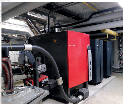
Chaufferie de l'EHPAD des Andaines à La Chappelle d'Andaines (61)
